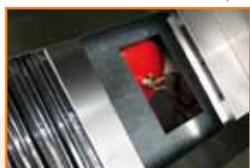
Depósito agente extintor
